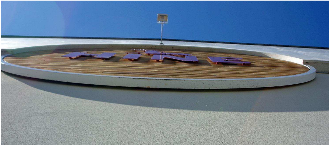
Photo 26 : absence d'indice de présence au niveau des anfractuosités sur les façades des bâtiments
