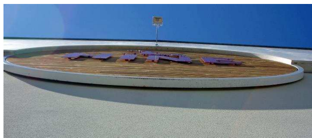
Photo 3 : décollement de l'enseigne avec le mur, potentiellement favorable pour les chiroptères (24/06/2021)
